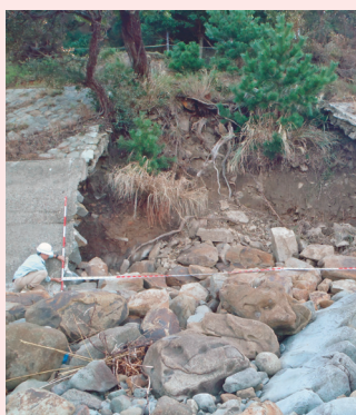
加太81号線被災状況
