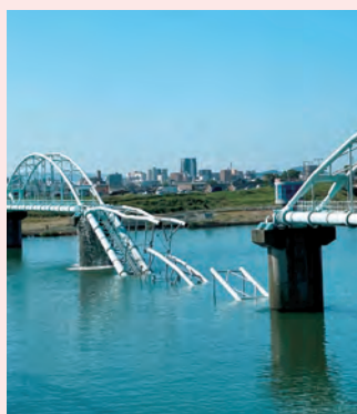
破損した六十谷水管橋
