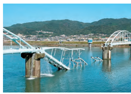
崩落した六十谷水管橋
