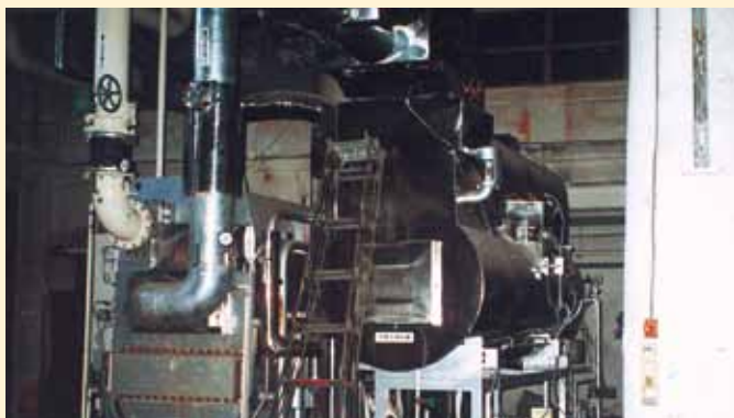
吸収式冷凍機
