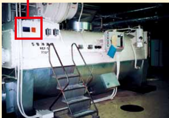
ターボ冷凍機
