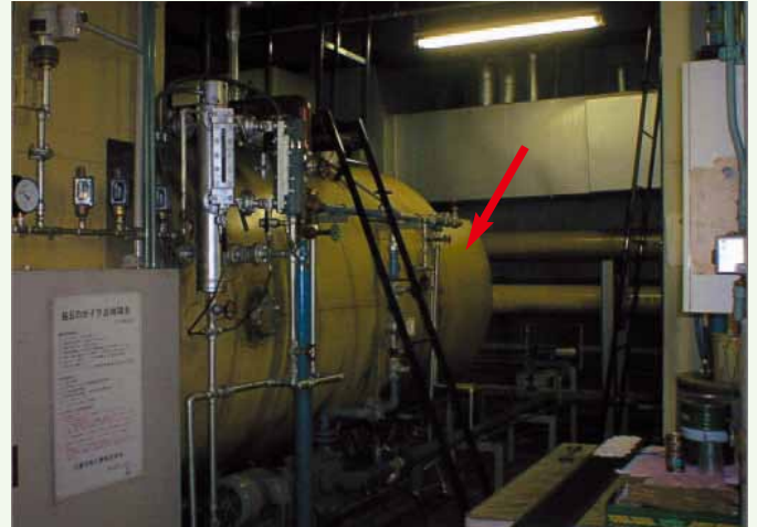
石綿含有保温材（ボイラ外周部）
