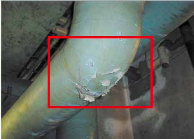
石綿含有保温材（配管曲がり部）
