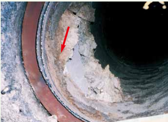
煙突断熱材（ライニング）
