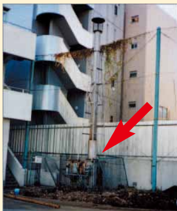
廃棄物焼却炉
