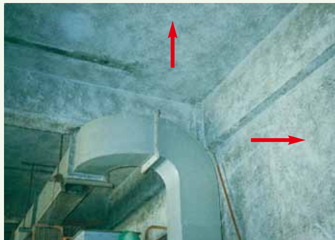
吸音用吹付け石綿・石綿含有吹付けロックウール（天井・壁等）
