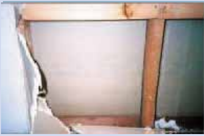
砒素・カドミ含有石膏ボード
