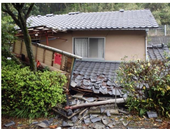
熊本地震の被災家屋（西原村）
