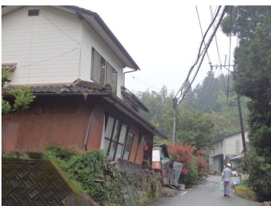
熊本地震の被災家屋（西原村）
