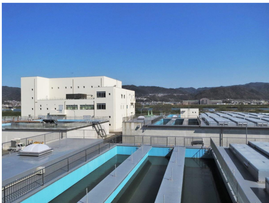
加納浄水場 凝集沈澱池
