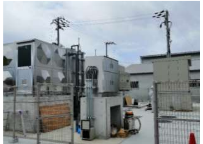
自家発電設備
