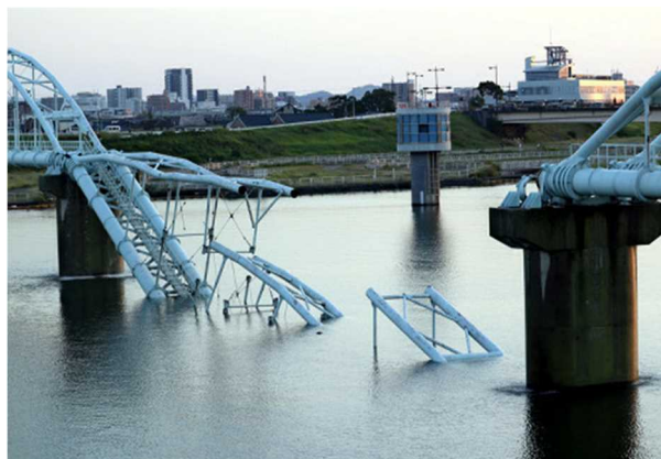
図 1.2 水管橋落橋状況
