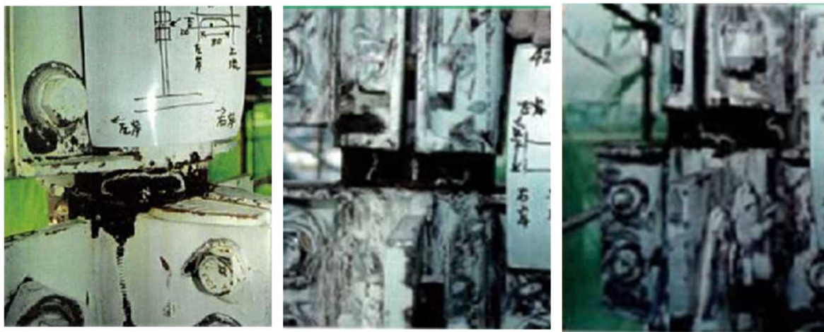
図 3.2 吊材の腐食状況（1993 年劣化調査）
