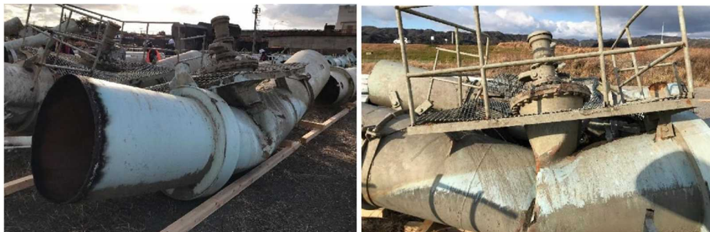
図 2.4 空気弁部の下弦材（通水管）の座屈状況
