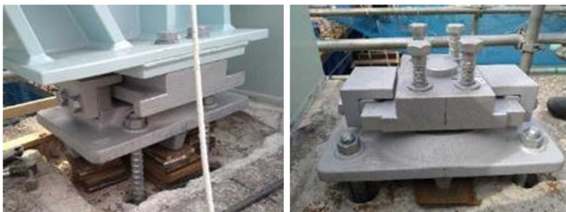
更新支承部（左：支承板支承【可動】 右：支承板支承【固定】）
