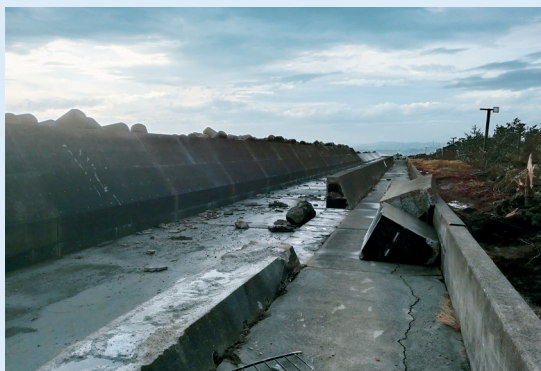
台風21号で大きな被害があった沿岸部
