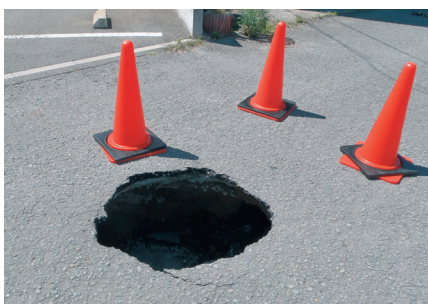
陥没している道路
