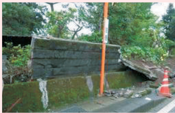
道路に面した危険なブロック塀
