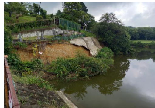
ため池 (法面の一部崩壊)
