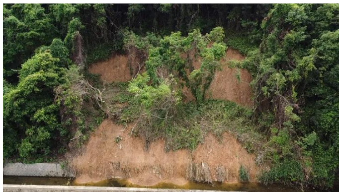
(被災状況の写真撮影)
