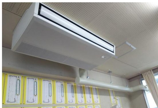
<空調改修事業>
