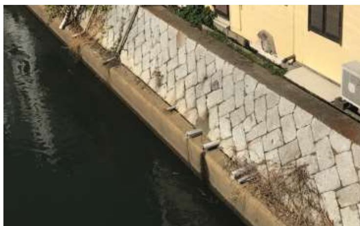
図表 1-3-10 市堀川護岸で見られる生活排水流入
