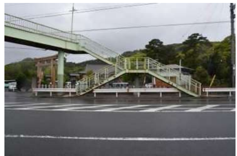
紀州東照宮前の老朽化した歩道橋
